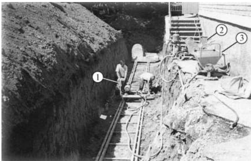
Рис. 2. Підсилення основи фундаментів горизонтальним армуванням ґрунтів при відновленні деформованої будівлі в стиснених умовах: 1 – станок горизонтального буріння; 2 – розчинонасос; 3 – розчиномішалка
